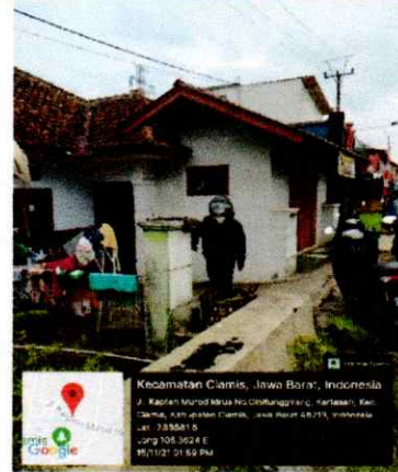
Lokasi pemasangan pipa (ekspose) diameter 300 mm, galian terbuka di Jl. Kapt Murod Idrus
